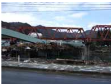
橋梁に流出物が堆積。
