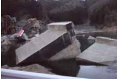
崩壊した高潮堤
