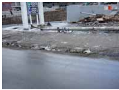
埋没した道路側溝
