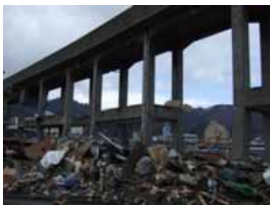
鉄道の橋脚部。 津波の方向に曲がっている。
