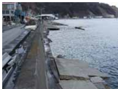
港湾内 岸壁崩壊。水門は維持。
